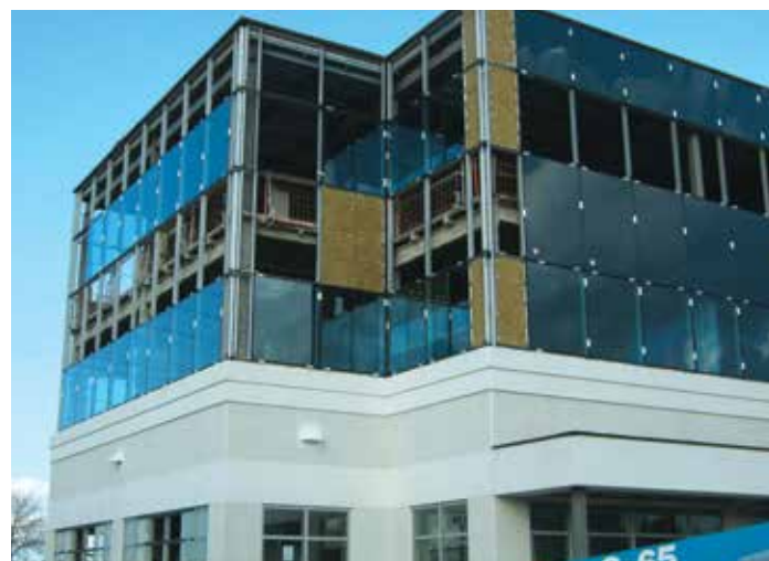
Le promoteur de Monterey Park a utilisé l'isolant CURTAINROCK MD dans son tout nouvel immeuble commercial de 6968 m 2 (75 000 pi 2 ) à Brampton, Ontario.
